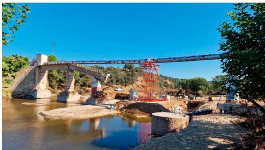
Imagen de la tubería del sistema Picadas-Almoguera tras el paso de la DANA en septiembre de 2023 Foto: Junta de Castilla-La Mancha
